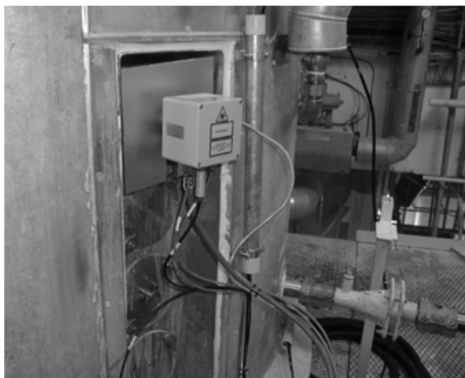
Abb. 2: Einbau der In-line-Partikel-Messsonde IPP 50-Se in einen Granulierer unter Ex-Schutz-Bedingungen.
